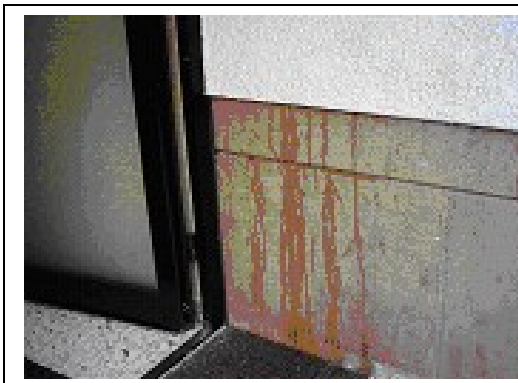
Folge: Durchfeuchtung von Mauerwerk der Wohnung
